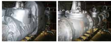
地下に配置された高温になるバルブ。このバルブ全体をフラインジャケットで包み込むように覆い、余分な放熱を防止することでエネルギー効率が向上する。
